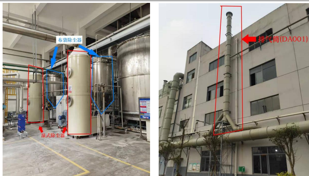
湿法除尘器+布袋除尘器
